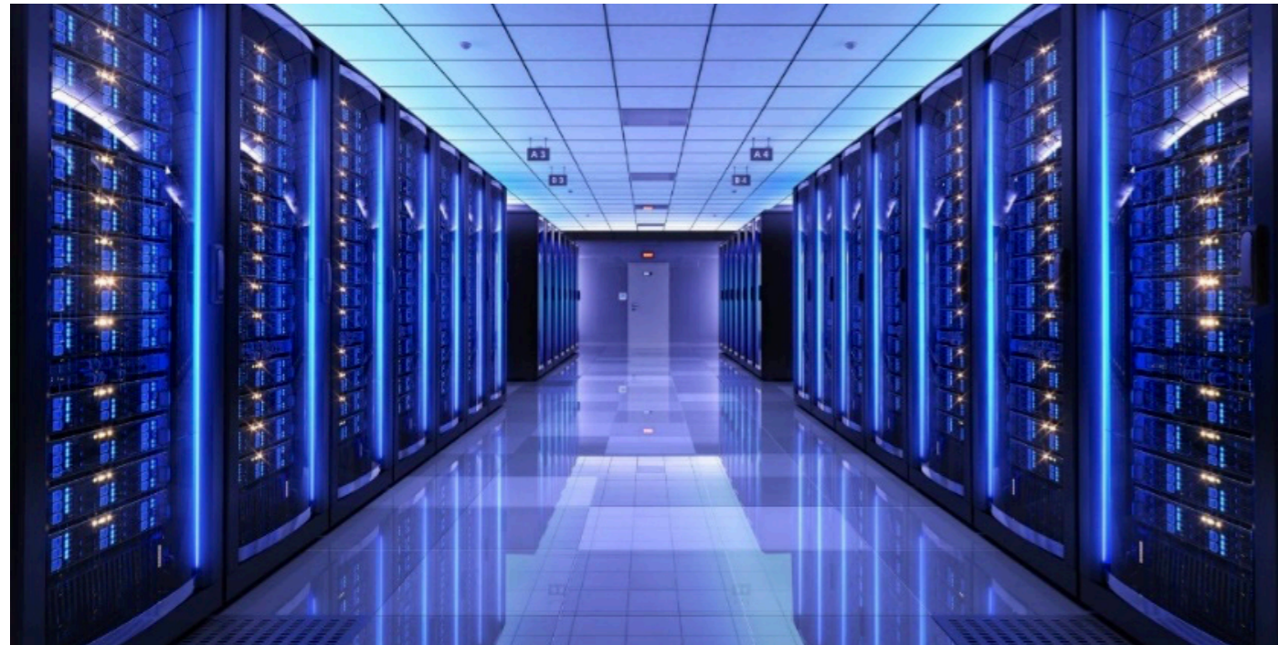
Figure 1 : Illustration d'un datacenter avec ses armoires
