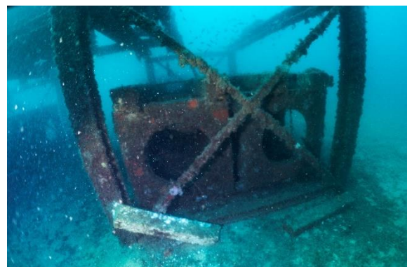
Figure 34 : Anodes détachées et posées au sol (printemps 2020)
