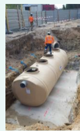
Séparateur hydrocarbures- YV
