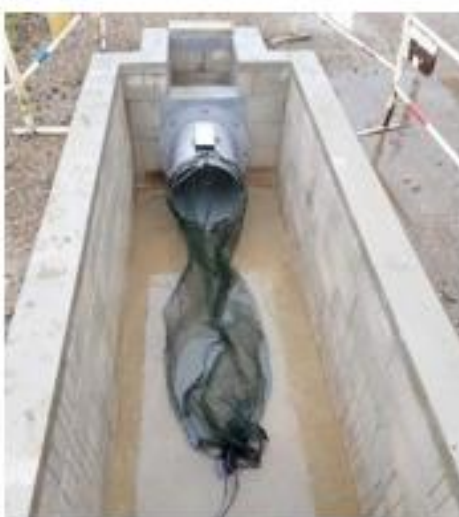
Exemple de filet installé en ligne (© Hydroconcept)
