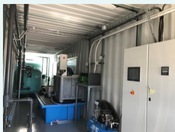
Local de traitement des eaux - ATLAS
