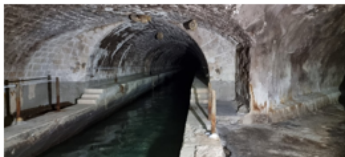
Premier émissaire au niveau de la liaison avec le 2 e émissaire
